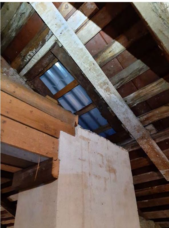
Koulun kattorakenteita. Muurin keskellä näkyy yksittäinen lepakon uloste.
